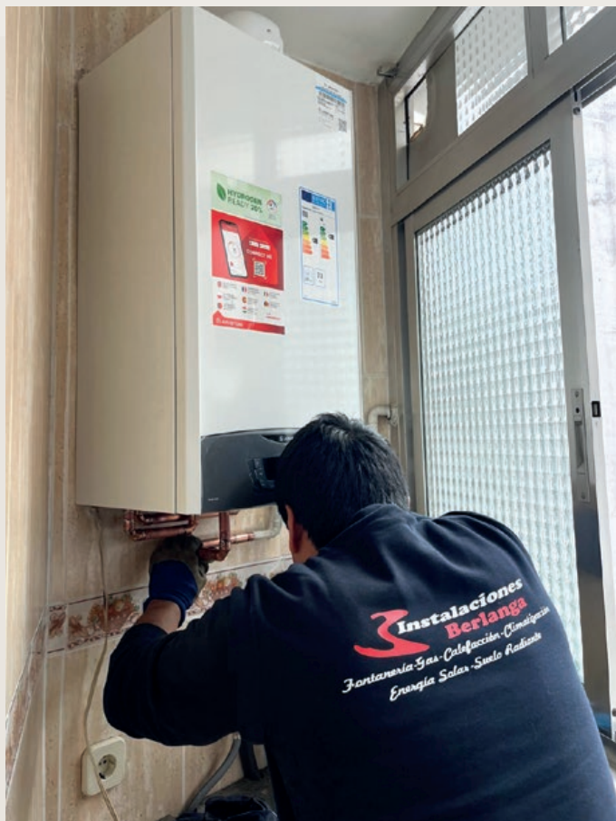
Hugo se encarga de instalar la nueva caldera en el domicilio de uno de los clientes.
