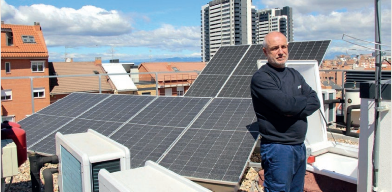
Azotea del edificio en el que se han instalado siete equipos de aerotermia con solar fotovoltaica en Bravo Murillo (Madrid).
